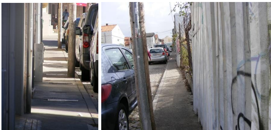
Figura 46 – Exemplos de passeios com anomalias ao nível da acessibilidade, na Rua da Agra Longa e na Rua Nossa Senhora da Bonança, respetivamente.
