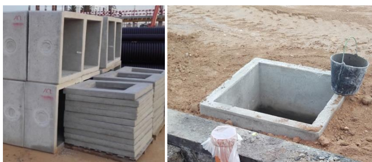
Figura 6.1-42 - Imagens tipo de caixa de ramal e telecomunicações
