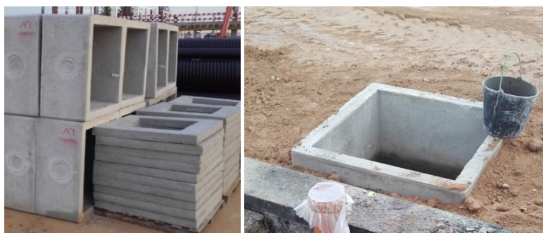
Figura 6.1-75 - Imagens tipo de caixa de ramal e telecomunicações
