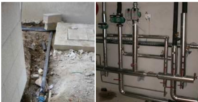
Figura 6.1-67 - Imagens de tubagem e acessórios das redes de águas
