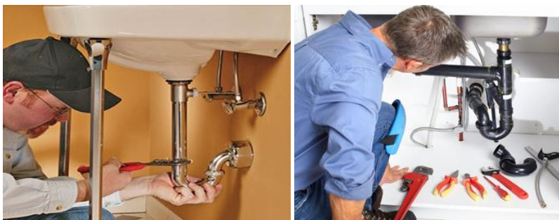
Figura 6.1-43 - Fotos tipo das instalações sanitárias
