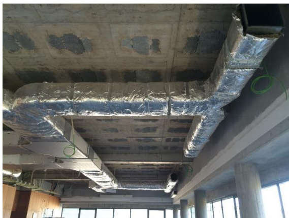
Exemplo de condutas de climatização (Sala de Controlo e Comando das Águas do Noroeste)
