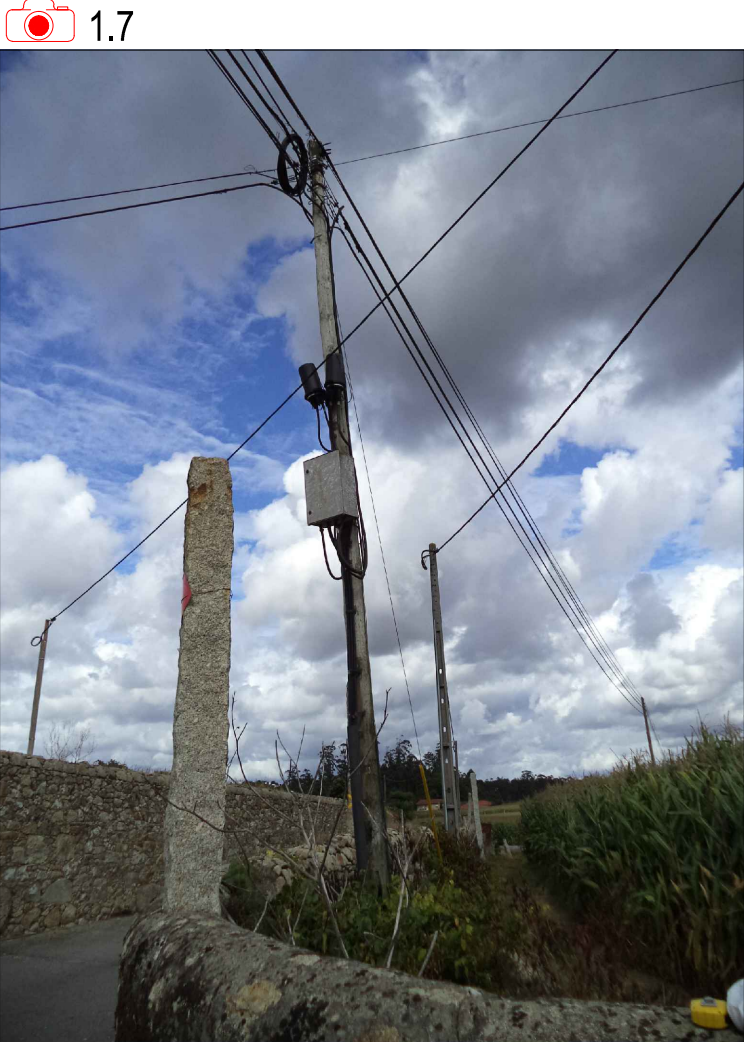
POSTE TELECOM E POSTE ENERGIA BT.
