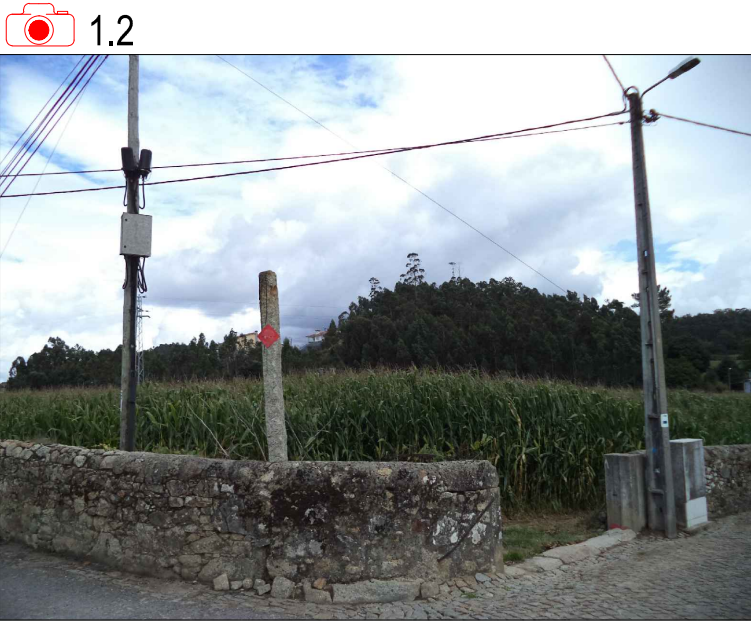
PORTÃO. TELECOM, ENERGIA BT E ILUMINAÇÃO.
