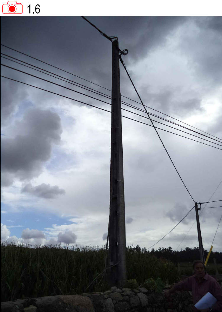
POSTE ENERGIA BT
