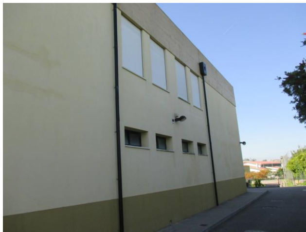
Foto – reboco fissurado
