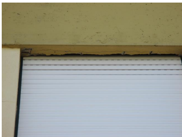
Foto – padieira com armadura à vista
