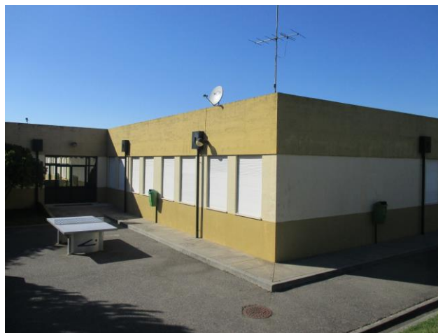
Foto – platibanda com revestimento descolado
