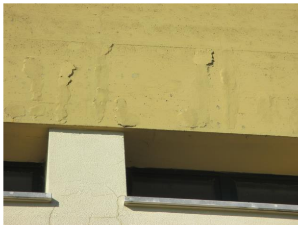
Foto – platibanda com revestimento descolado
