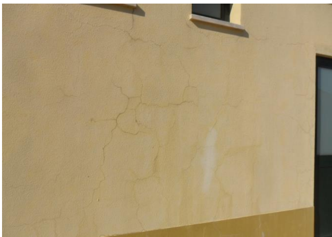
Foto – Fachada do pavilhão com fissuração
