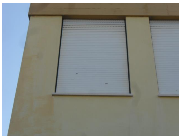
Foto – estore danificado
