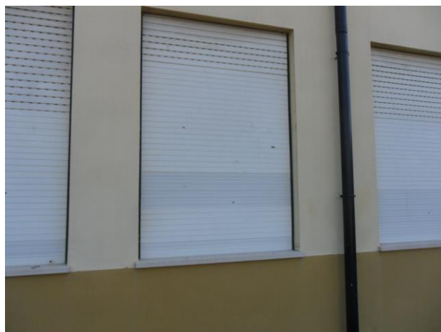
Foto – estore danificado
