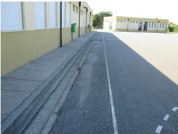
Foto – depressões pavimento exterior
