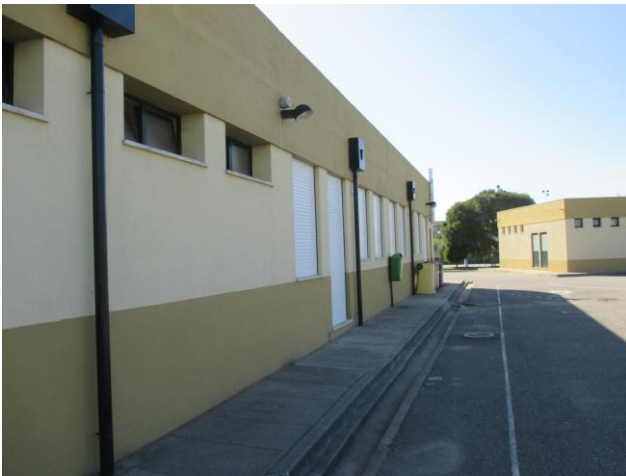
Foto – depressões pavimento exterior
