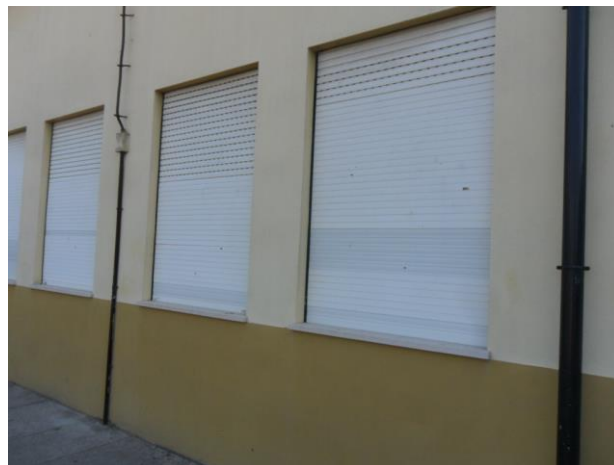
Foto – estore danificado
