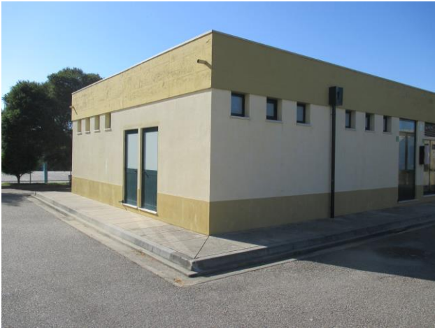
Foto – fissuração em fachadas
