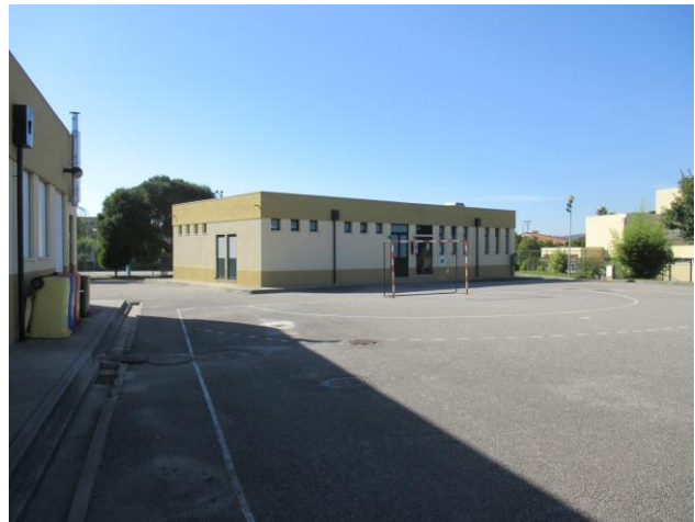
Foto – depressões pavimento exterior
