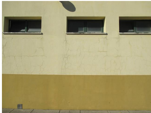
Foto – fissuração em fachadas
