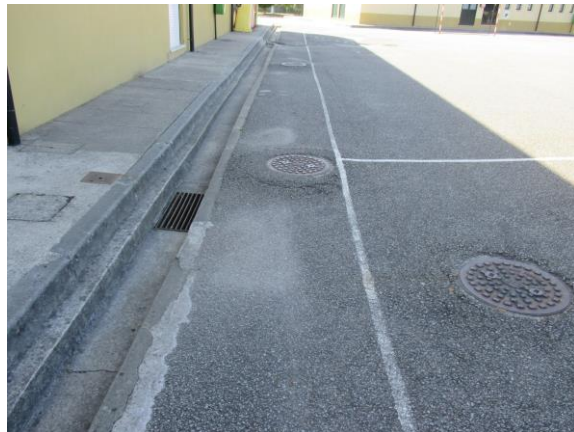
Foto – depressões pavimento exterior
