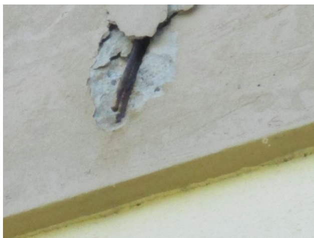
Foto – platibanda com armadura à vista
