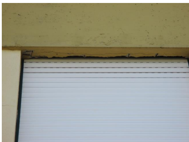
Foto 5 – padieira com armadura à vista
