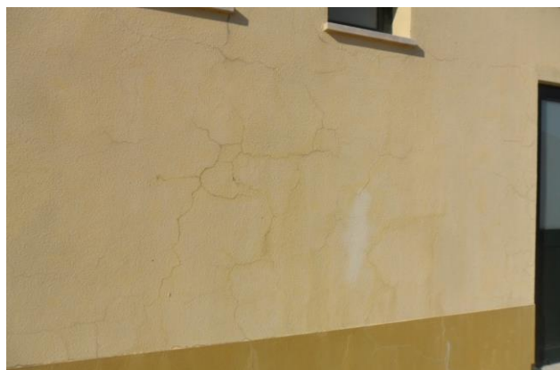
Foto 32 – Fachada do pavilhão com fissuração
