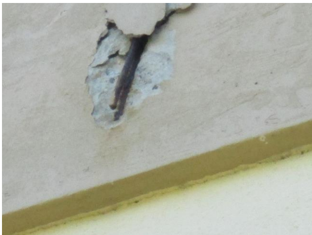
Foto 7 – platibanda com armadura à vista
