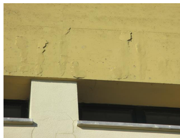
Foto 12 – platibanda com revestimento descolado
