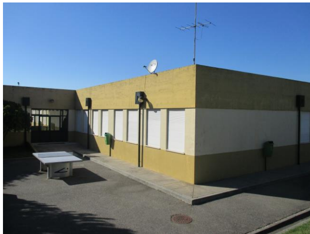
Foto 8 – platibanda com revestimento descolado
