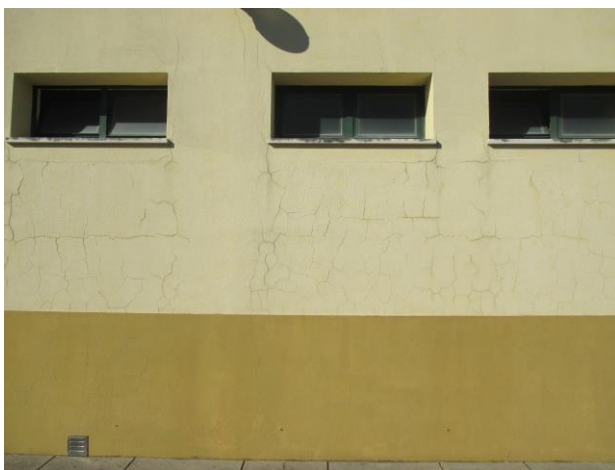
Foto 10 – fissuração em fachadas
