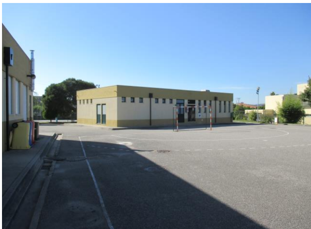
Foto 26 – depressões pavimento exterior
