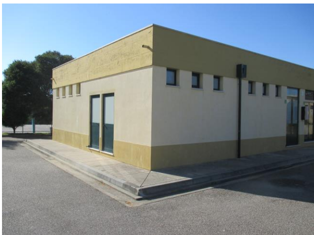
Foto 9 – fissuração em fachadas
