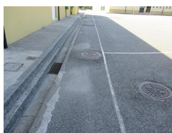
Foto 24 – depressões pavimento exterior
