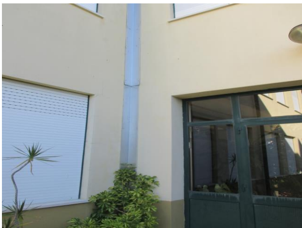
Foto 27 – junta de dilatação
