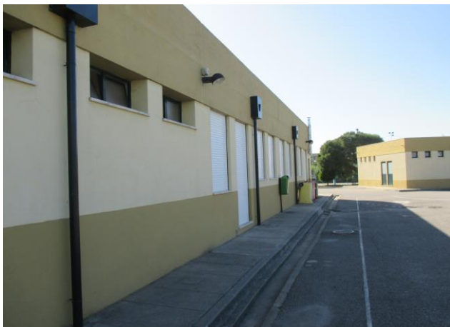
Foto 25 – depressões pavimento exterior
