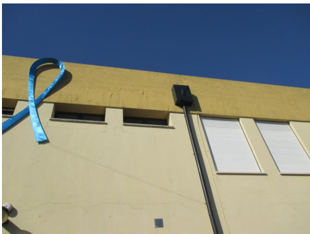
Foto 11 – fissuração em fachadas
