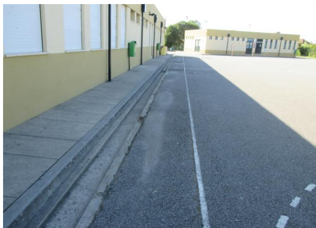
Foto 23 – depressões pavimento exterior
