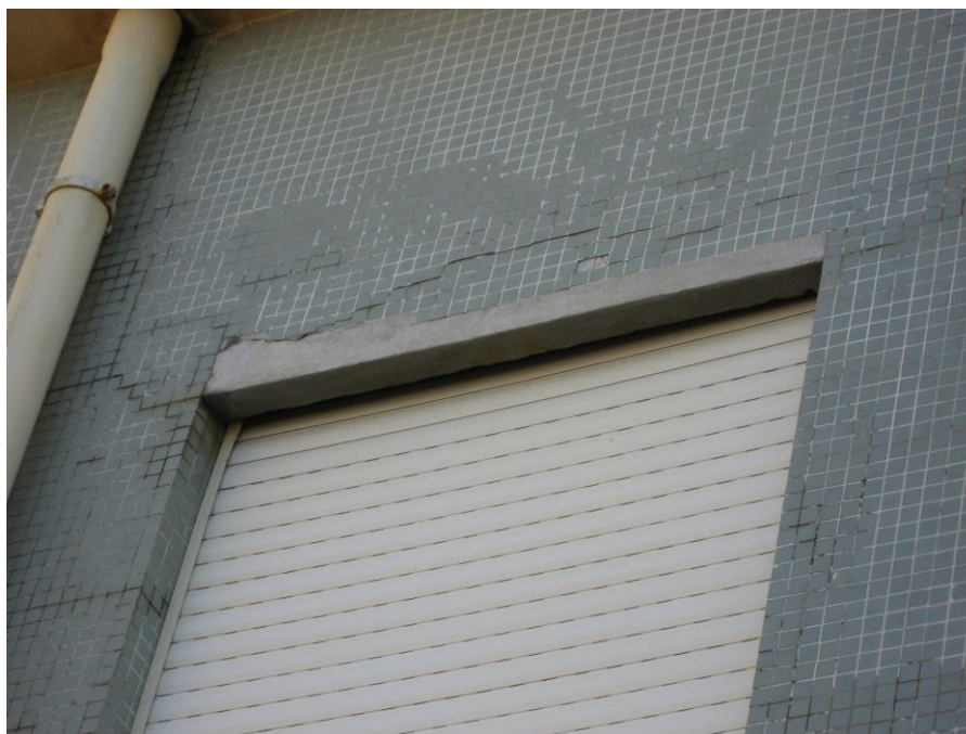
Fig. 3 – Fissuração presente em fachadas
