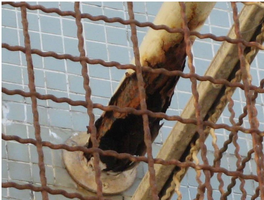
Fig. 4 – Elementos metálicos fortemente corroídos
