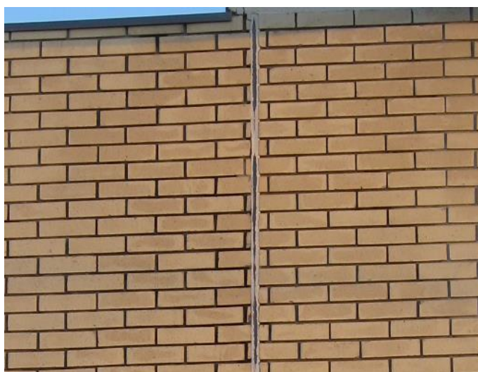
Fig. 4 – Fissuração em juntas de dilatação
