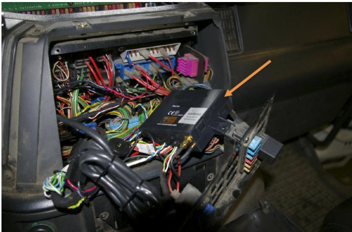
Figura 14-9 - Instalação de GPS numa viatura de recolha
