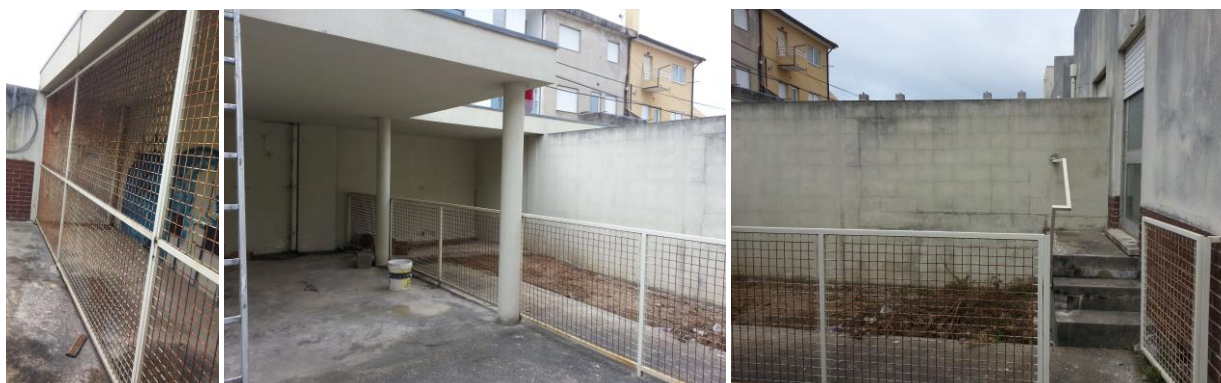
Ilustração 41 - Imagens das vedações em ferro a recuperar
