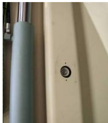
Vista exterior do ponto de lubrificação
