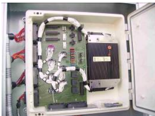
Nova caixa central de controlo
