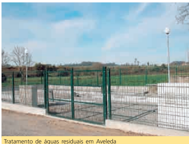
Tratamento de águas residuais em Aveleda
